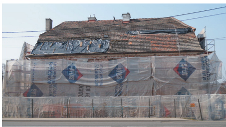
Z elewacji budynku w Nowym Jaworowie zbity już tynk elewacyjny.
